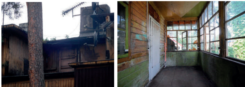
Ryc. 19. Zły stan techniczny budynków przy ul. Wileńskiej 8 (z prawej, fot. K. Błaszczuk, 2018) i Toruńskiej 9 (z lewej, fot. W. Pardala, 2014)
